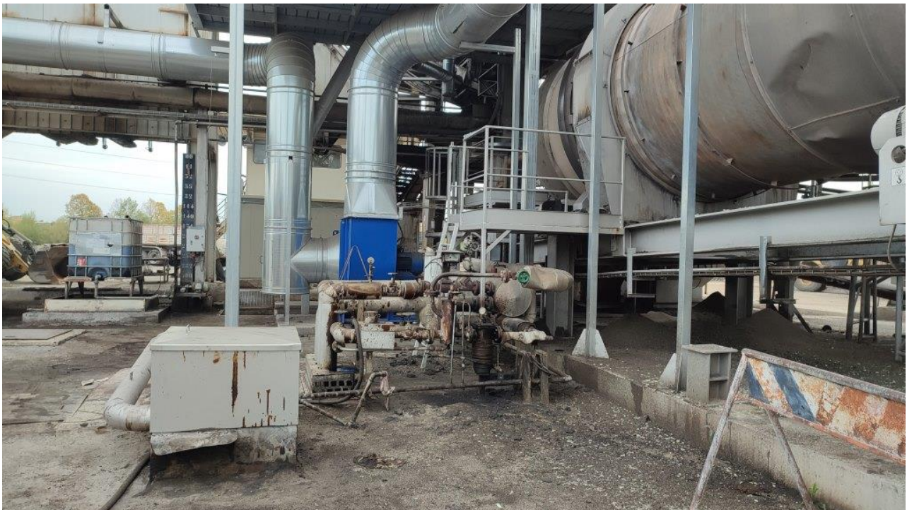
Figura 5: Vista del chiusino del pozzo di pompaggio dal serbatoio e collegamenti al bruciatore sulla sinistra
