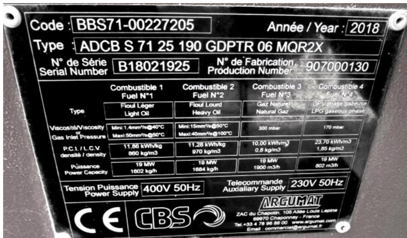
Figura 4 : targa del bruciatore installato con caratteristiche di funzionamento.
