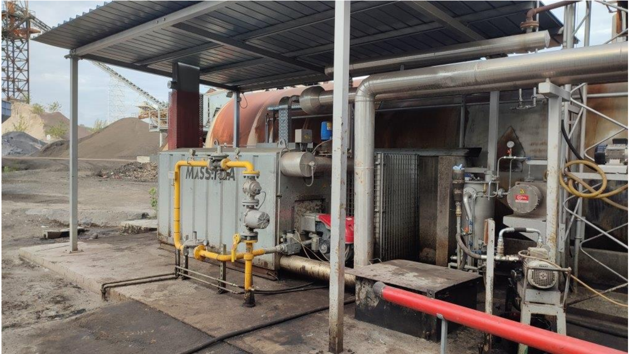
Figura 6: Vista dell'attuale caldaia
